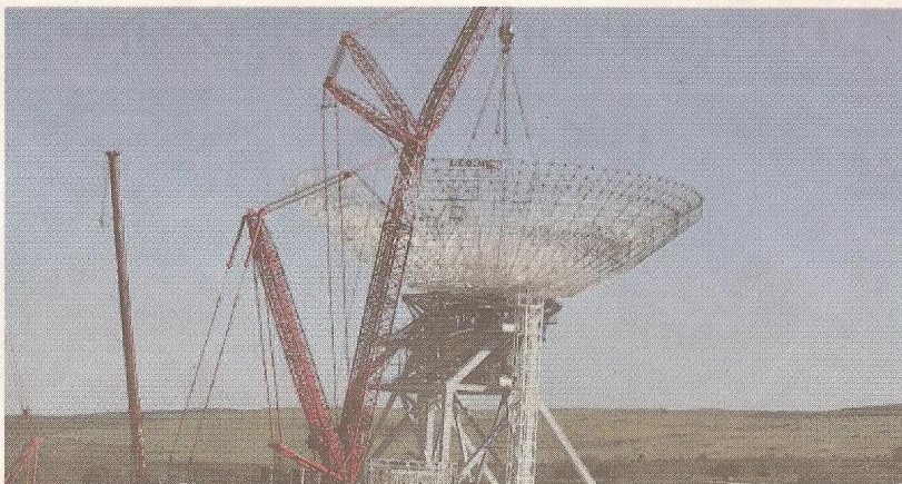
Il montaggio dell'antenna sul radio telescopio di San Basilio [FOTO FABIO MARRAS]
